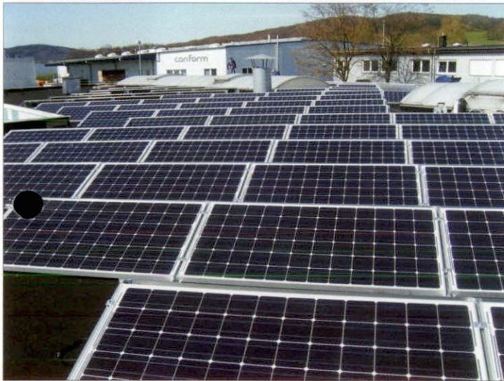
Im März diesen Jahres installierte die Firma Schneiker eine große Photovoltaik-Anlage in Gartnisch.
