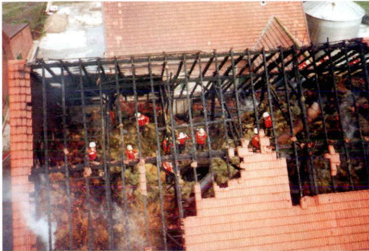
Ein Blitz entzündet alle Dachbalken gleichzeitig – durch den enormen Druck der Hitze fliegen die Dachpfannen wie Papierschnipsel herunter
