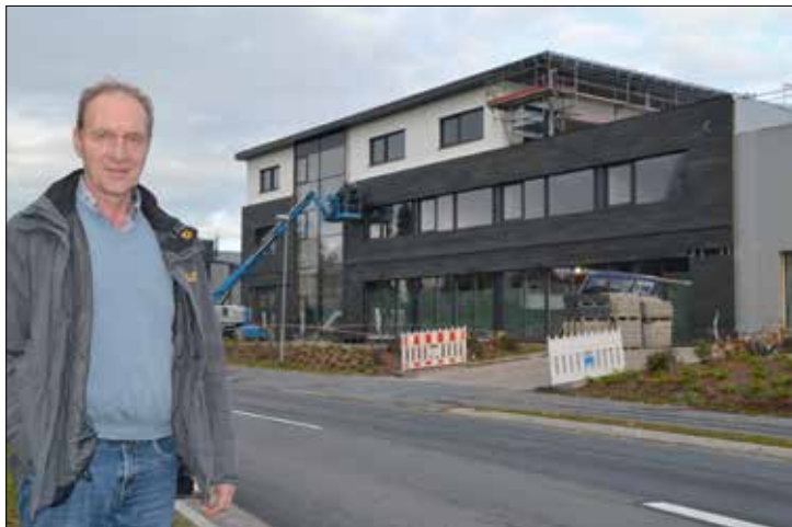
Noch gut vier Wochen, dann zieht Matthias Stüve mit seinem Handwerksbetrieb ‚Versorgungstechnik Stüve‘ in den imposanten Neubau am Künsebecker Weg 53
