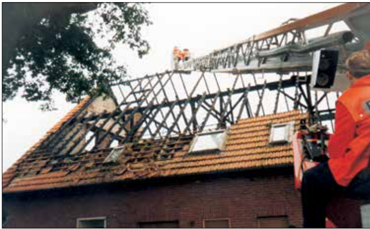
Die Drehleiter der Haller Feuerwehr war am Stockkämper Weg 33 bei der Brandbekämpfung sehr hilfreich
