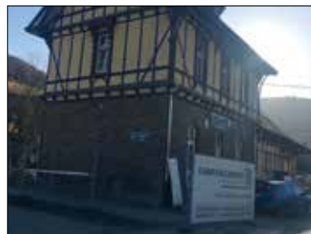
.... und wurde von der Flut im Sommer diesen Jahres stark in Mitleidenschaft gezogen
