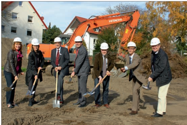
Erster symbolischer Spatenstich für den Bau eines Jobcenters auf dem Gelände des Berufskollegs Halle. Das Foto zeigt v.l. Bürgermeisterin Anne Rodenbrock-Wesselmann, Architektin Birgit Melisch, Kreisdirektor Christian Jung, Fachbereichsleiter Ingo Kleinebckel, Bauunternehmer Oliver Schröder, Geschäftsführer Fred Kupczyk und Architekt Peter Westerbarkei.
