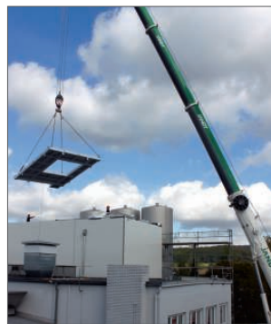
Millimeterarbeit leistete ein Kranführer, als er Teile einer Folienmaschine durchs Dach der Firma Nordenia gleiten ließ.
