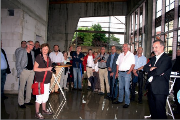
... und der Regen ließ die bereits gefüllten Becken überlaufen und die Besucher aus Politik, Wirtschaft, Verwaltung, Schulen und Vereinen sowie die Baubeteiligten bekamen nasse Füße!
